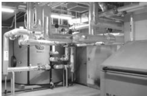
▲新庁舎薪ボイラー
